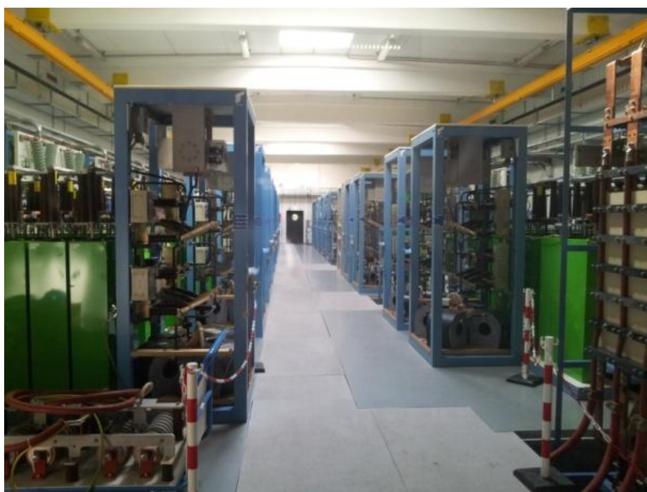
Рис. 21. Общий вид на зал с банками конденсаторов.
